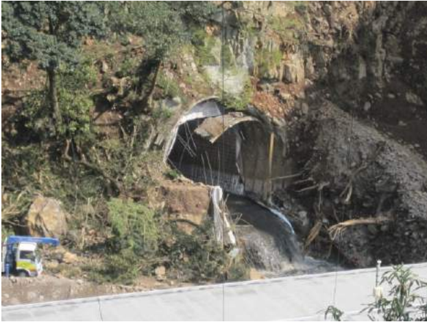
(写真3)破損した仮排水路トンネルの出口
