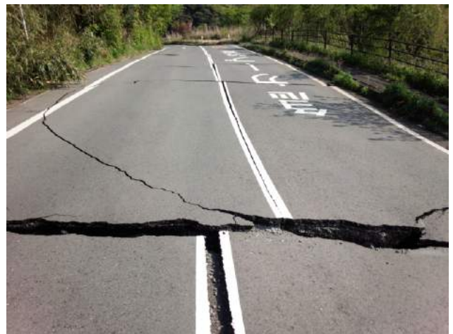
(写真5)確認した横ずれ断層
