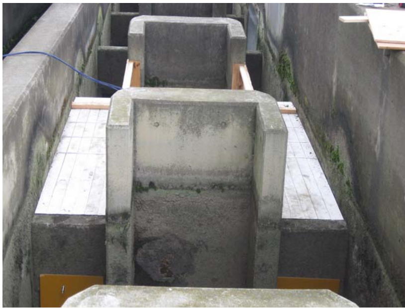
写真 10. センサー部 場所：1号魚道隔壁部
