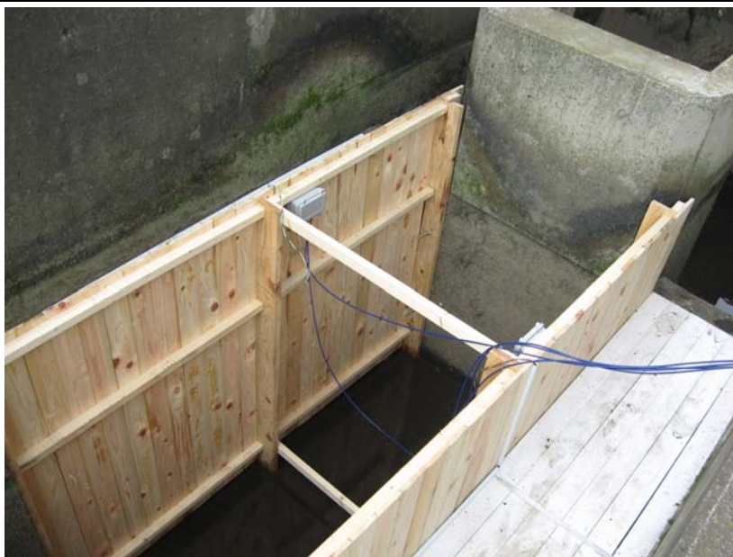
写真 12. 計測機器の配置① 場所：1号魚道隔壁部
