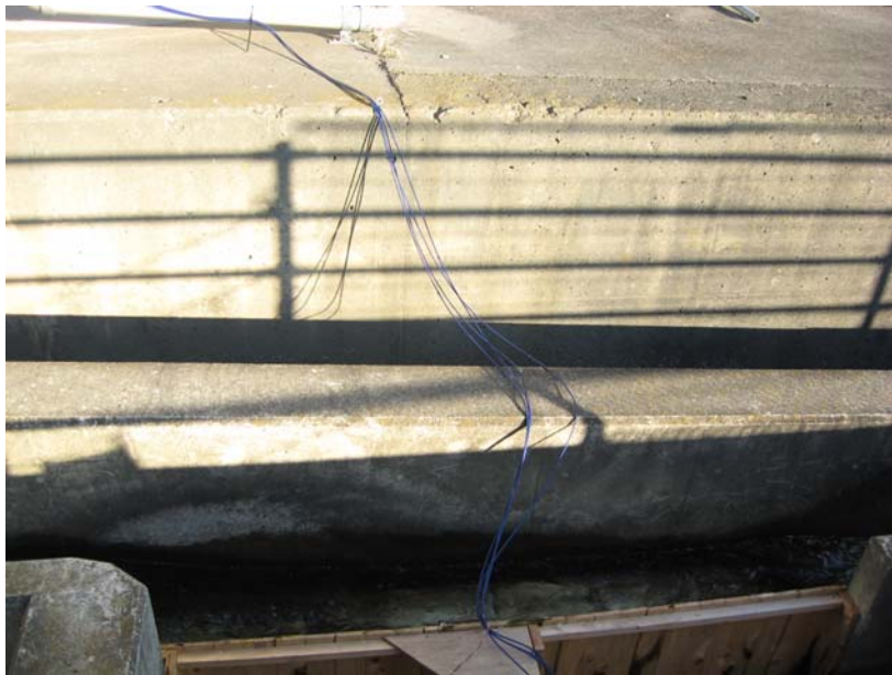
写真 16. センサー部の配線
