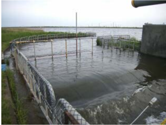
写真 3.5.1 平成 19 年 5 月 11 日の堰上流側の水位
