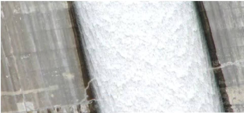
写真 中央漏水箇所 09.06.14 常時洪水吐 流路のすぐ右岸側。水 平クラックと枝分かれ したクラックとの分岐 点付近から漏れている ようである。
