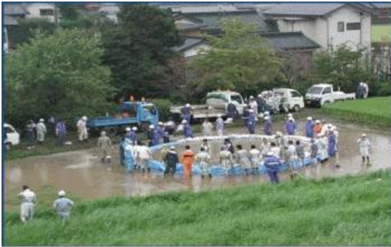
●埼玉県加須市漏水状況(H13台風15号)
