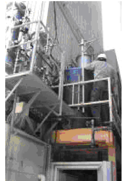
ホテル横に設置されている地下水のろ過設備＝神戸市中央区、ホテルサンルートソプラ神戸
