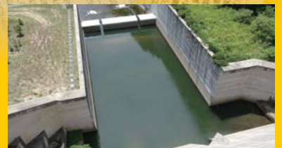
ダム本体と副ダムの間にヘドロや土砂が堆積していた。
