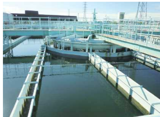
高速凝集沈でん池
