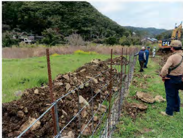
農業用水路を破壊し水田に土砂搬入 2023.3.22
