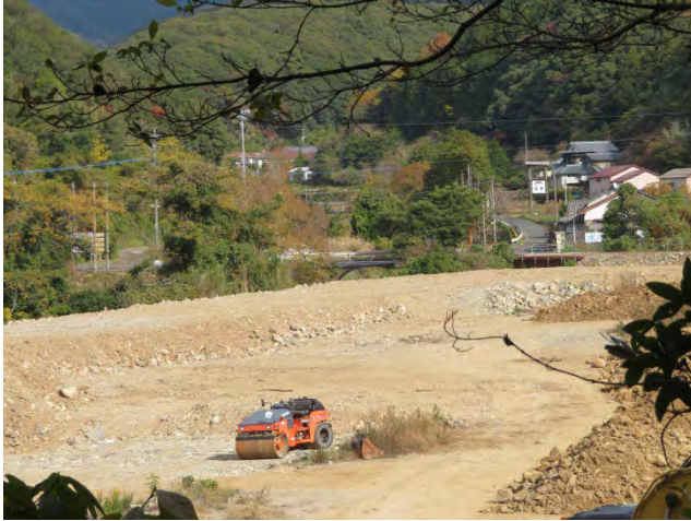
農業用水路破壊後の水田破壊 2024.12.10
