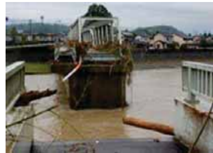
③西瀬橋の流失 (人吉市)
